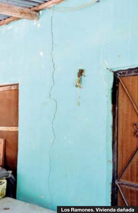
Los Ramones. Vivienda dañada
